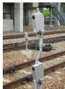
踏切障害物検知装置
