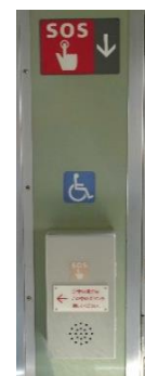
非常通報装置 2
