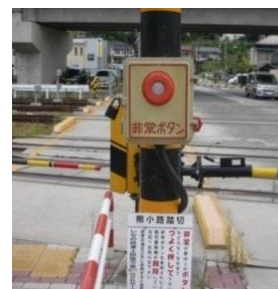
踏切支障報知装置
