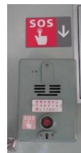
非常通報装置 1
